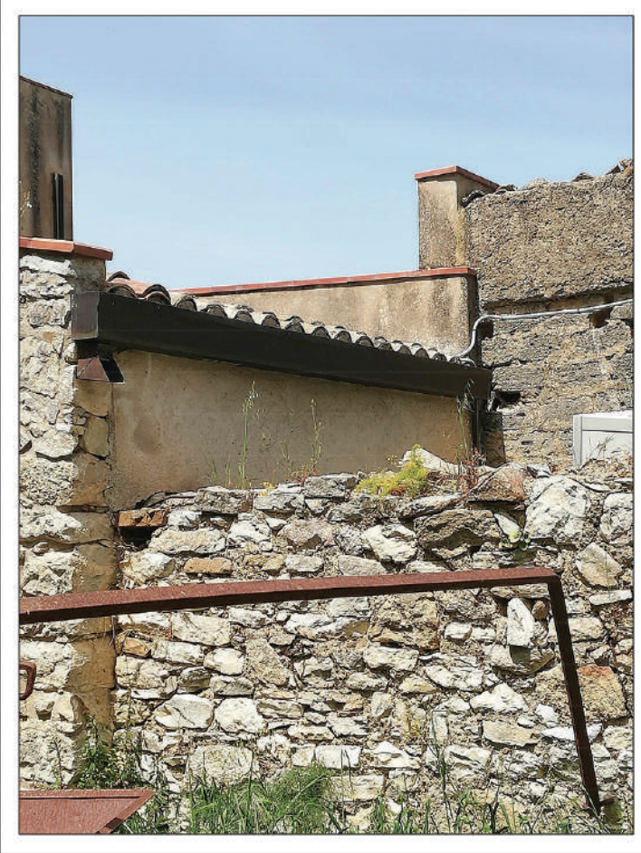
c. muratura portante parzialmente diruta
